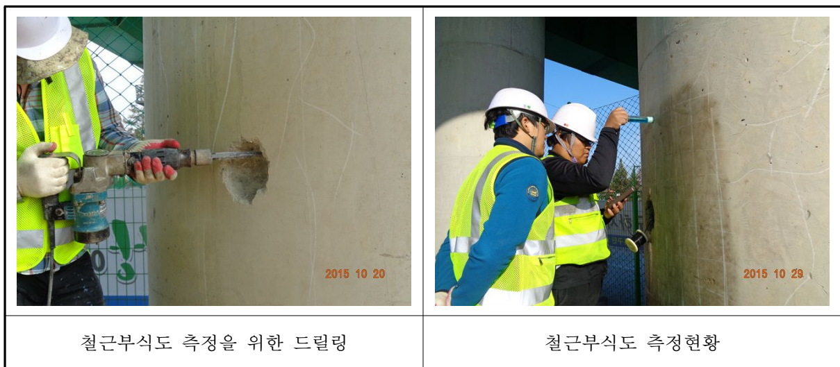
〈사진 3.26〉 철근부식도 현황
